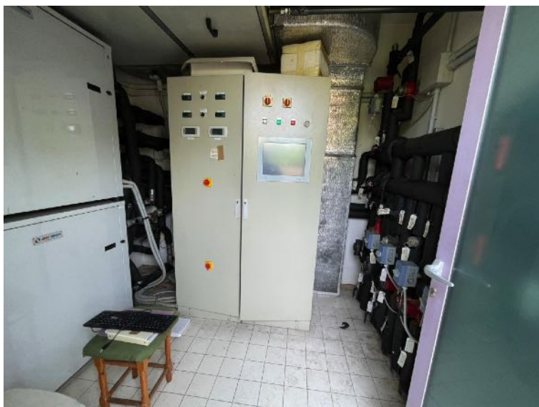
Centrale termica comune (piano terra)
